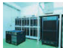
第2電源高調波室
