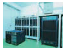
第2電源高調波室
